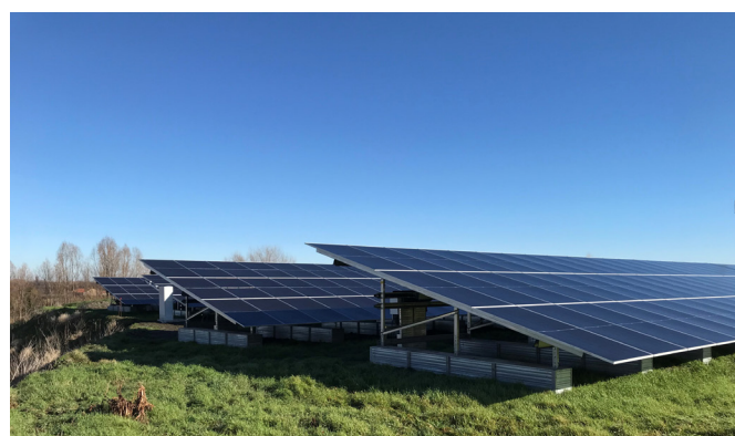
La centrale photovoltaïque construite
