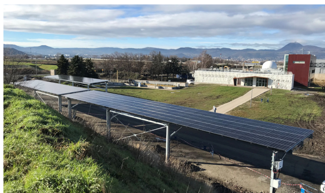
Les trois ombrières photovoltaïques installées
